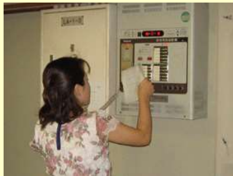
▶ 11時01分45秒 通報連絡班員 火災報知機受信盤で出火場所の確認後、館内非常放送(1階休憩室)
